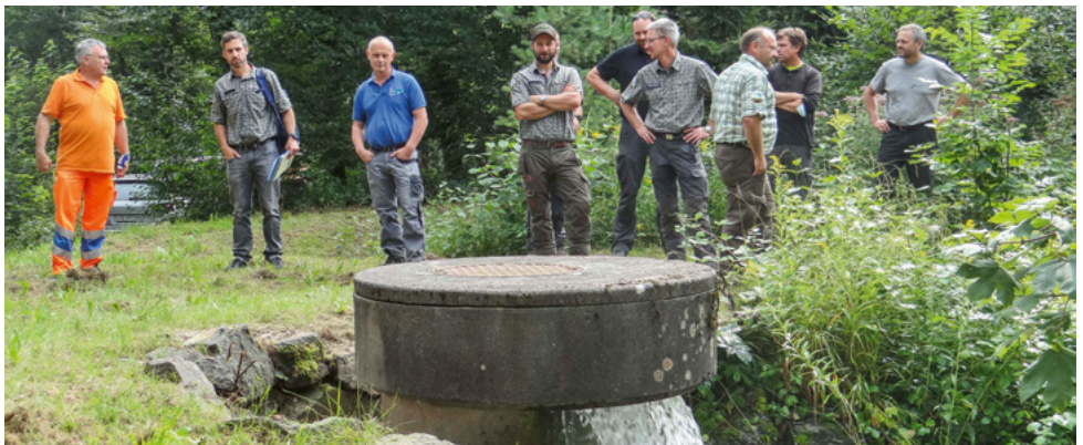
Einlaufschacht der Grundwasserschutzzone im Auholz Sulgen. Thurwasser wird in ein Absetzbecken im Wald eingespiesen und kann 20 Tage später als Trinkwasser verwendet werden. Foto: Sandra Horat
