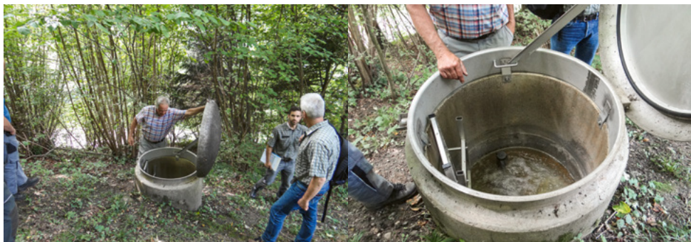
Beispiel einer Quelfassung im Grundwassergebiet Öltishausen, die noch nicht den neuesten Stand der Technik aufweist. Foto: Sandra Horat
