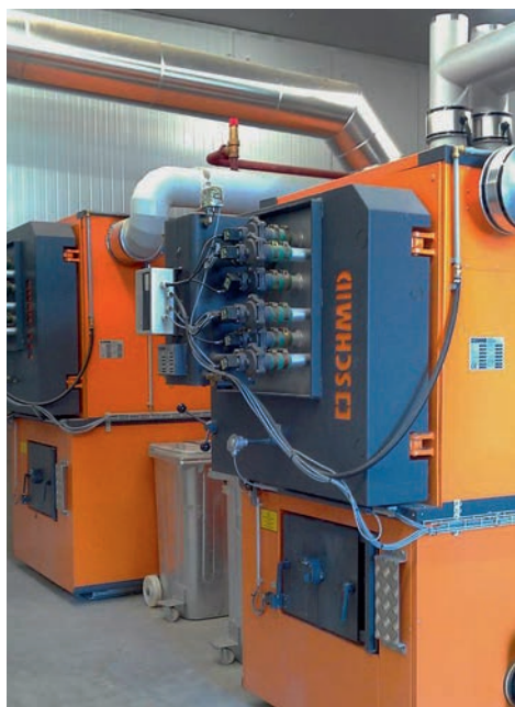
Die beiden Schnitzelheizungen des Wärmeverbundes Felben-Wellhausen. Foto: Lorenz Neher
