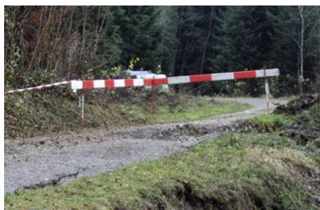
Eine abgerutschte Waldstrasse kann ohne Absperrung einen Haftungsfall zur Folge haben. Foto: Urban Hettich
