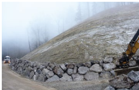
Mittels baulicher Massnahmen konnte die Hangneigung deutlich reduziert werden. Foto: Joachim Malt
