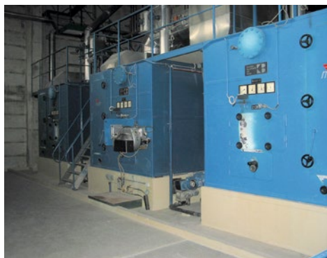
Herzstück der Heizung bilden die drei Heizkessel à je 800 Kilowatt. Sie ermöglichen einen komfortablen ganzjährigen Heizbetrieb. Foto: Hans Weber
