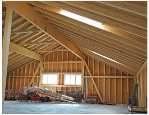
Beim gesamten Werkhofbau legte die Gemeinde Bussnang Wert auf Arbeit von lokalen Unternehmen und auf lokale Produkte. Das Holz für den Dachstock und die Fassade stammt aus dem Wald der Bürgergemeinde Bussnang. Foto: Claudia Meile
